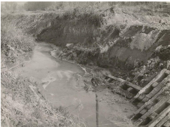
1. 11. 1987: Čerstvě zregulované koryto Stropnice neustálo první velkou vodu.
